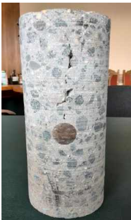
Рисунок 8 – Дефект в бетоне, возникающий при погружении металлических дюбелей (трещина над погруженной арматурой)
