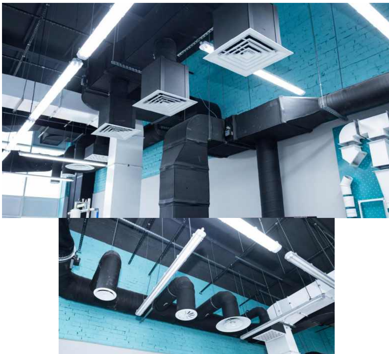
Рисунок 14 – Элементы стенда с воздухораспределителями
