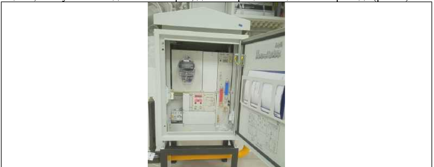
Рисунок 3– Станция катодной защиты
