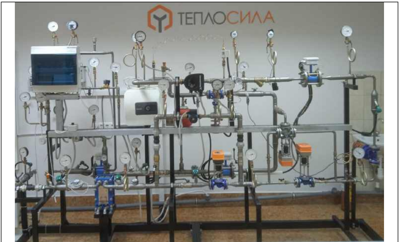
Рисунок 16 – Индивидуальный блочный тепловой пункт
