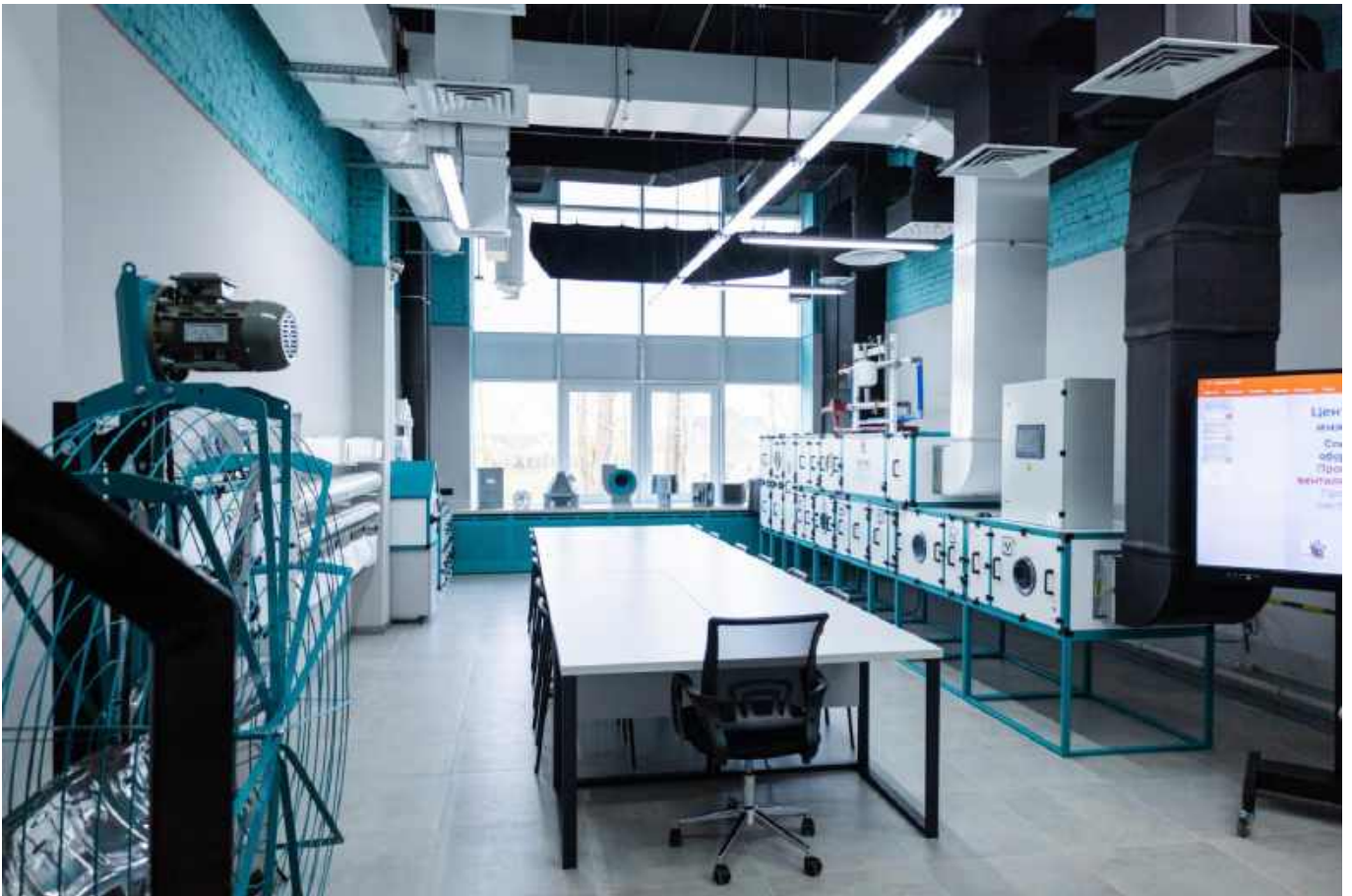
Рисунок 11 – Общий вид лаборатории «Вентиляция и кондиционирование»
