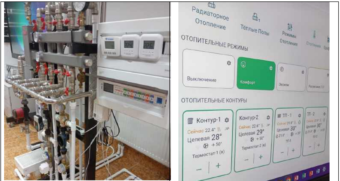
Рисунок 18 – Стенд «Автоматизированные и умные системы теплоснабжения и отопления»
